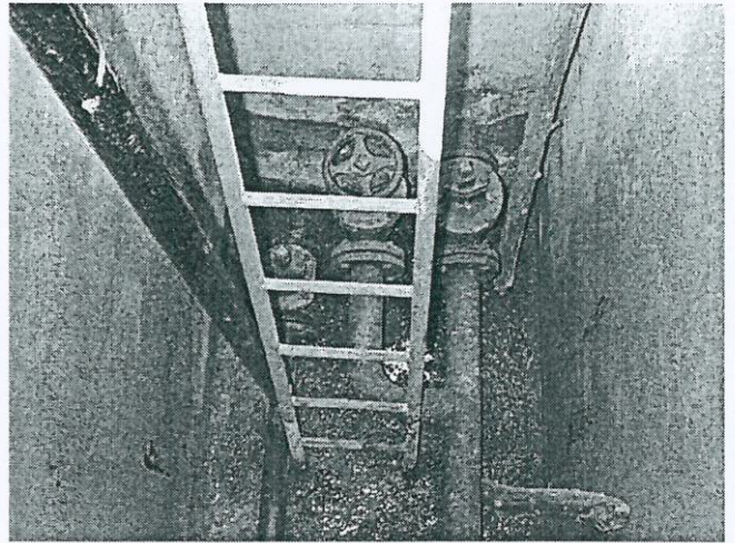
Les conduites à l'intérieur de la chambre de vanne sont corrodées
