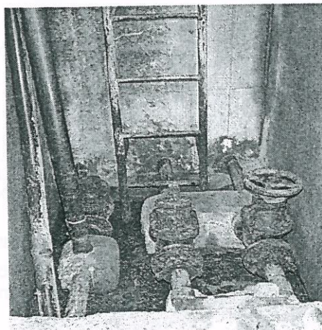
Chambre de vanne du réservoir Audiberts haut
