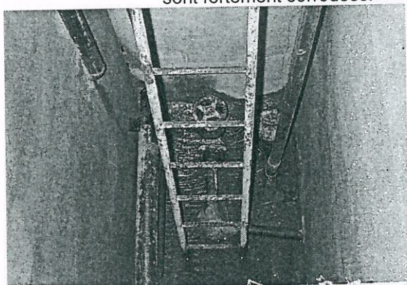
Chambre de vanne du 25m 3
