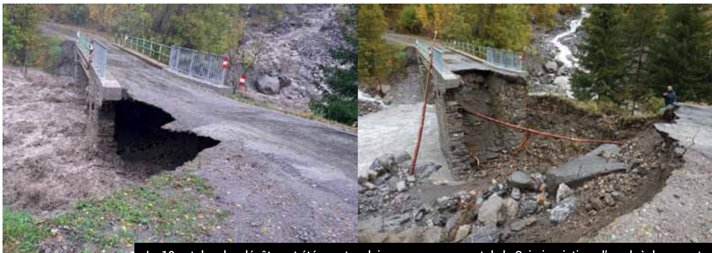
Le 18 octobre, les dégâts ont été spectaculaires, comme au pont de la Scierie, victime d'une brèche ouverte.
